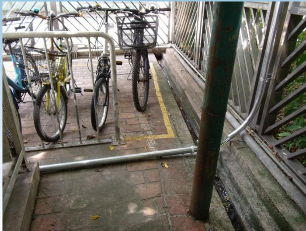
重整C座連接保安室之防水地線，確保中心外圍電力供應穩定
